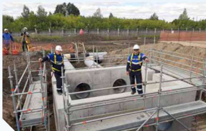
Очистные сооружения. Заказчик: АО «Газпромнефть – ОНПЗ».
