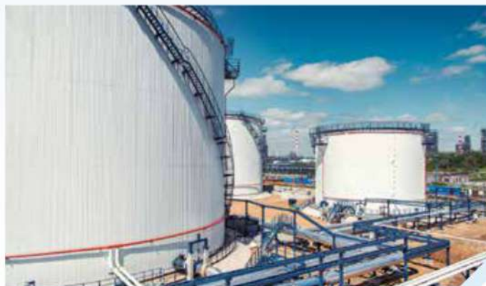
Очистные сооружения АО «Газпромнефть-ОНПЗ». Заказчик: АО «Газпромнефть-ОНПЗ».
