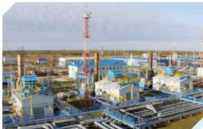
Продуктопровод ШФЛУ «Мыльджинское ГКМ – Казанское НГКМ – ж/д терминал СПБТ в г. Куйбышеве. Заказчик: АО «Востокгазпром».
