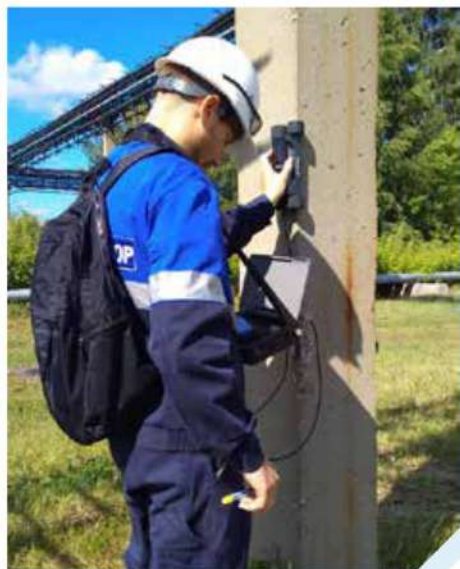
Парк приготовления и хранения темных нефтепродуктов на ТСБ-1. Заказчик: АО «Газпромнефть – ОНПЗ».
