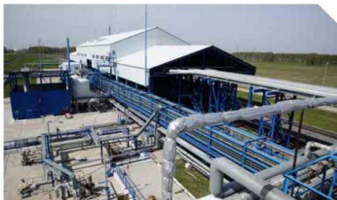
АУТН-1. Автоматическая установка тактового налива. Заказчик: АО «Газпромнефть-ОНПЗ».
